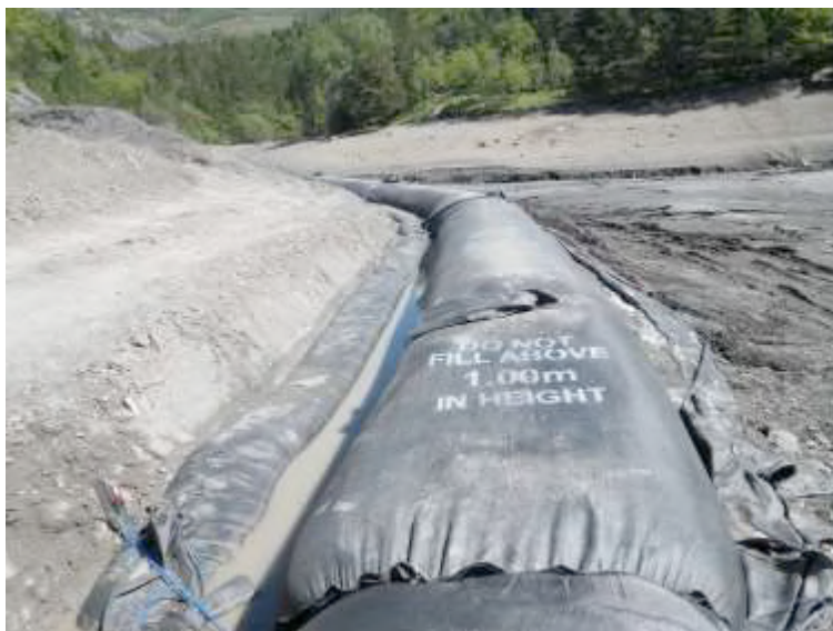
Figure 7 : Photographie de la pose d'un Géotube® sur la zone de terrassement. ©SMADESEP
