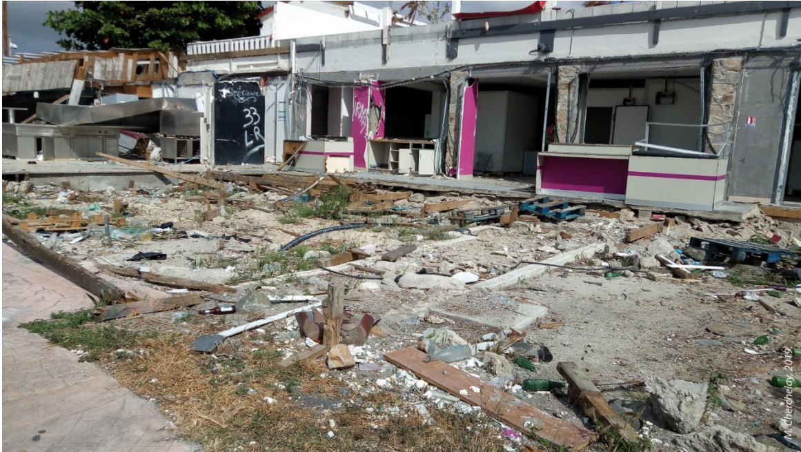
Photographie 24. Commerce détruit près du front de mer à Marigot en mars 2018
