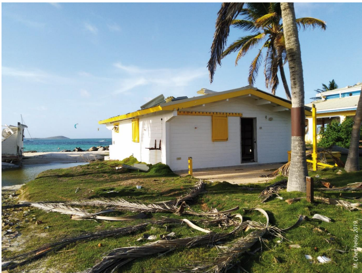
Photographie 41. Un des bungalows endommagés du Club Orient, juillet 2019.
