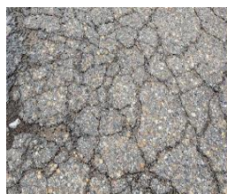
Fissuration par Fatigue
