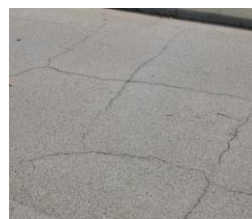
Fissuration des Blocs
