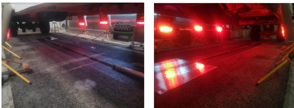
Figure II-36 : Système de chauffage posé sur la surface de la fosse
