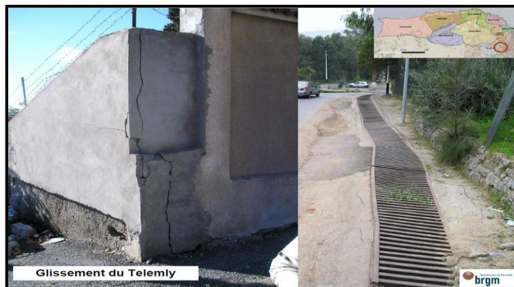
Figure 101: Glissement lent observé en 2005 à Télémely, Alger
