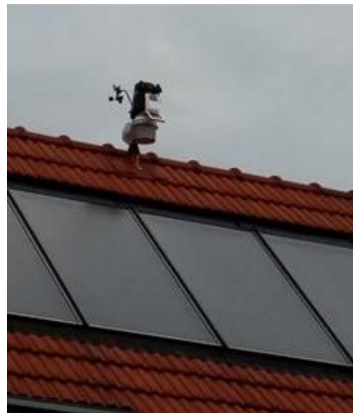
Figure IV.8 : Emplacement de la station-météo sur la toiture
