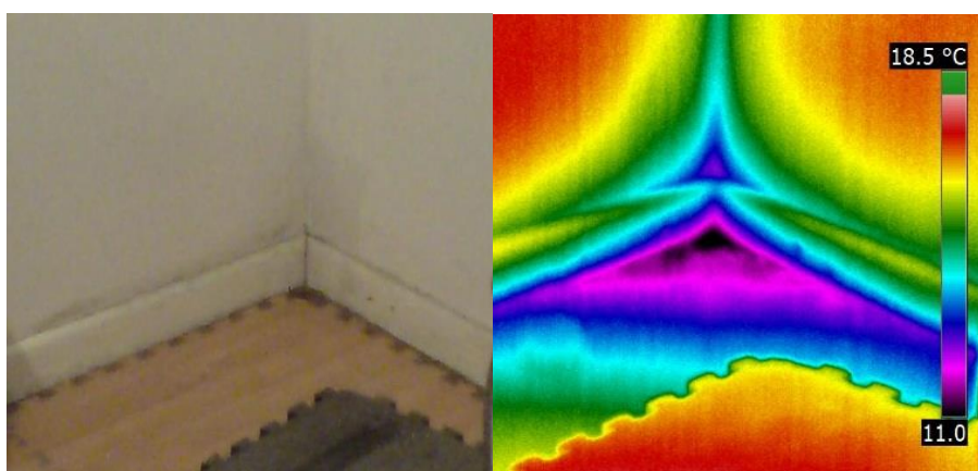
Figure IV.5 : Thermographie infrarouge intérieure dans le bureau
