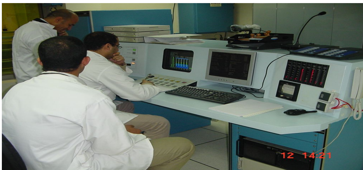
Figure 10 : Salle de contrôle (de commande) du réacteur
