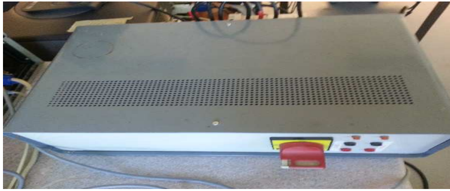
FIGURE 4.26 – Alimentation 14 volts (batterie).
