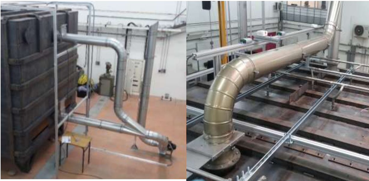
Figure 14 :Gaines de ventilation pour l'admission et l'extraction d'air.
