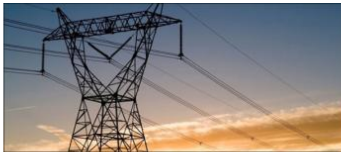
Figure I-4 Photographie d'une ligne haute tension
