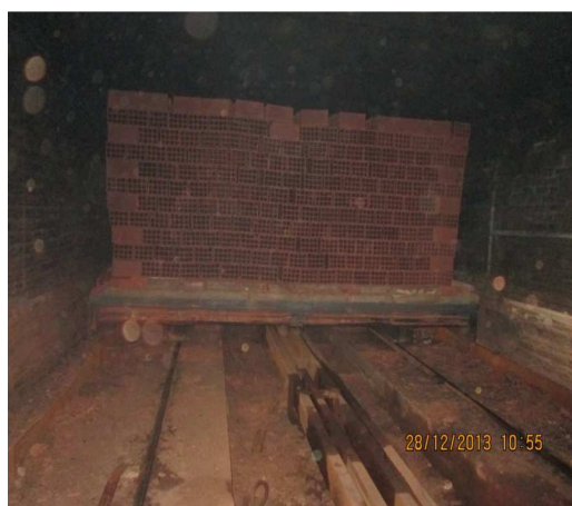
1.(b) : Arrière feu (refroidissement) (briquerie médnine)
