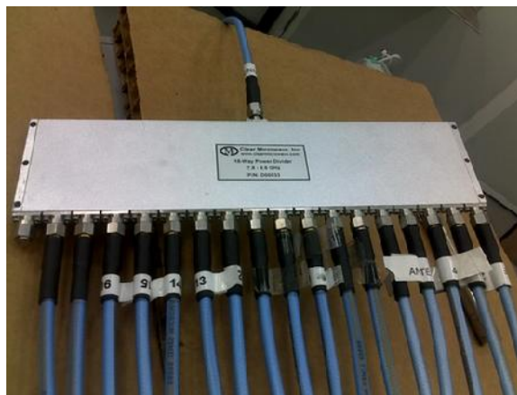
Figure III-15: Mesure du diviseur de puissance de commerce (18-Way Power Divider, Clear Microwave Inc).
