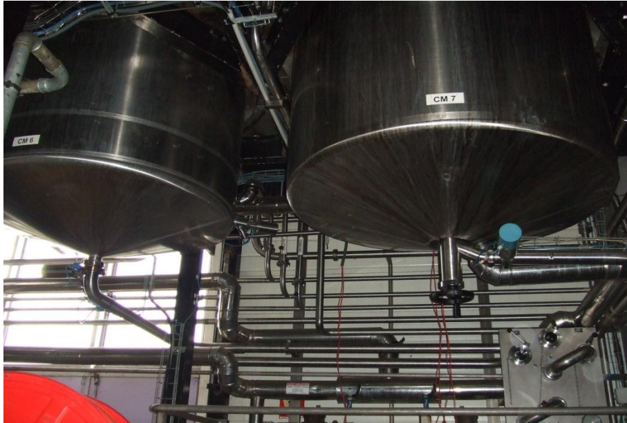
8. Réservoirs et tuyauteries. (Aromatics, Grasse 06) (Cl. P. Rosini.)
