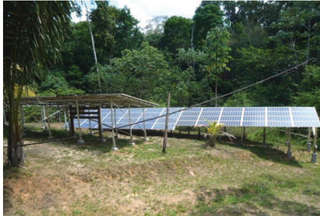
Figure 13. TropiScat : Panneaux solaires alimentant en électricité le camp et les appareils scientifiques.
