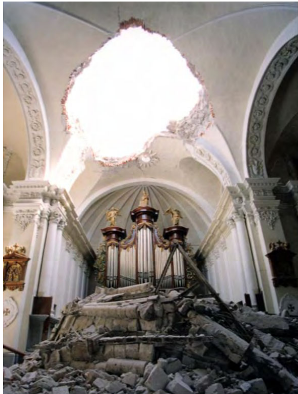
FIGURE 9-13 : Toit de la cathédrale d'Arequipa percé par l'effondrement de l'une des tours lors du tremblement de terre de 2001. Photo : Fredy Salcedo, 2001.
