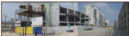
Photo 23 : Réalisation de logement entre le nouveau centre d'affaire de La Joliette et le boulevard de Paris, octobre 2007, (BOURSE).
