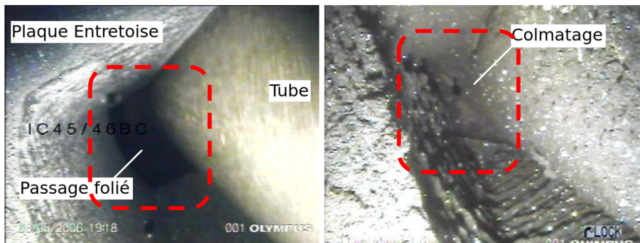
FIGURE I.5 – Passage folié sur une plaque entretoise : (à gauche) état initial lors de la mise en service, (à droite) passage folié colmaté au bout de 15 à 20 ans d'activités. Ces photos sont prises "de dessus" c'est-à-dire à l'inverse du sens de l'écoulement. PRUSEK (2012).
