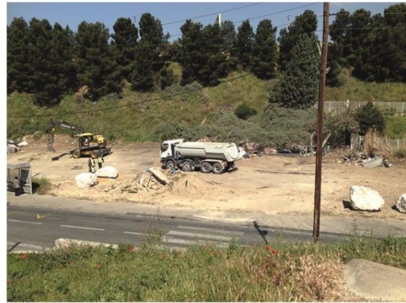
16 avril 2014 : dégradation du terrain
