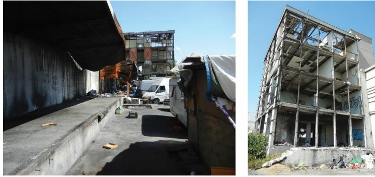
Figure 106 : Terrain rue Frédéric Sauvage : bâtiment et auvent en état d'insalubrité, avril 2014, photos prises par M. Serre
