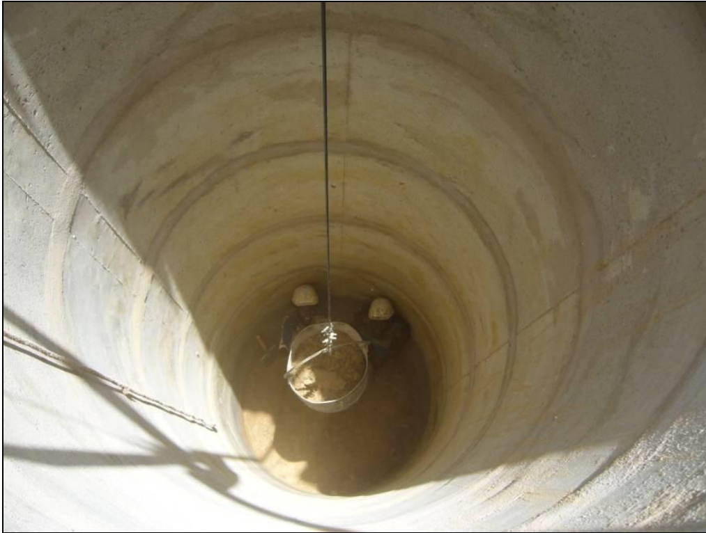
Puits moderne en construction dans le canton Salamat Sifera à Gafala (Cliché Abdellatif Fizzani, janvier 2007).
