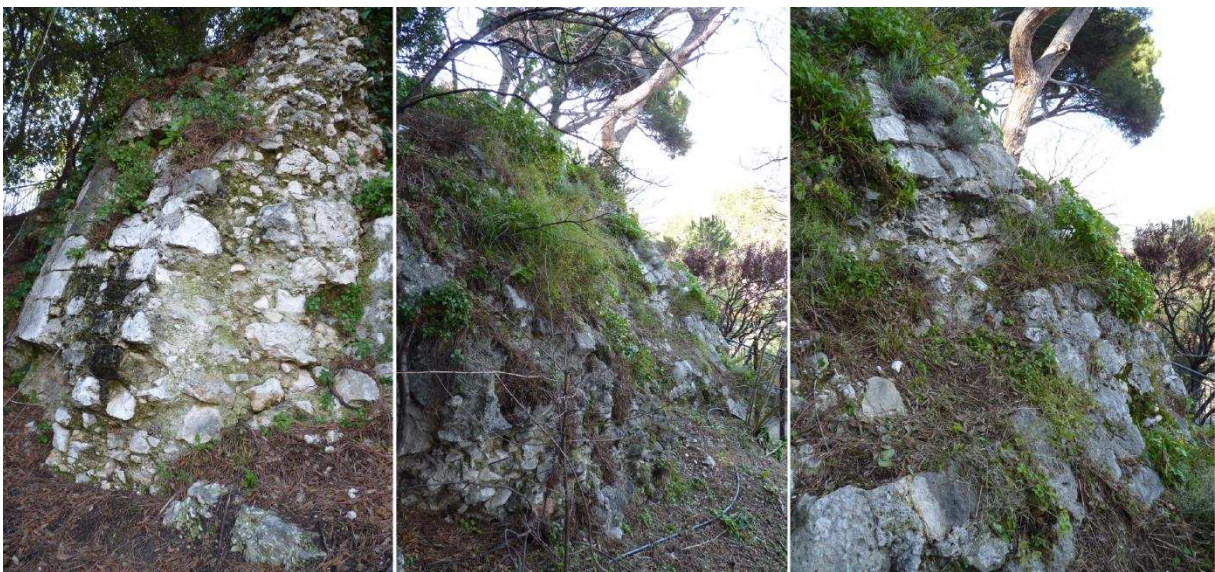
Figure 315 : Flanc du bastion à tenaille Saint-Jacques détaché de ses fondations et basculé vers l'intérieur par l'action de la poudre contenue dans des trous de barre à mine (cl. E. Guilloteau).
