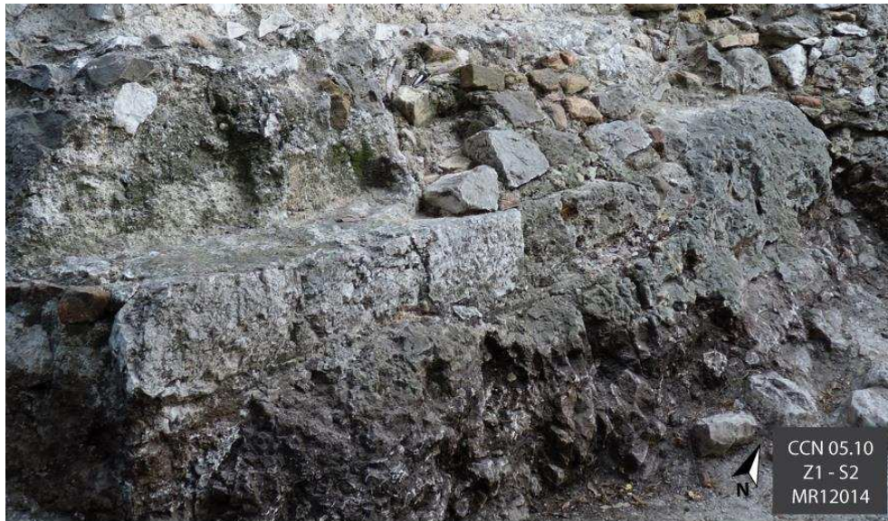
Figure 70 : MR12014 avec dans la partie haute le blocage et les négatifs de pierres de taille (Cl. E. Guilloteau/SAVN).
