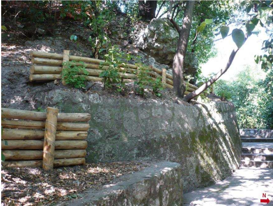
Figure 51 : Base supposée de la tour Saint-Charles, avec un remontage contemporain s'appuyant sur les fondations de cette dernière (Cl. E. Guilloteau/SAVN).
