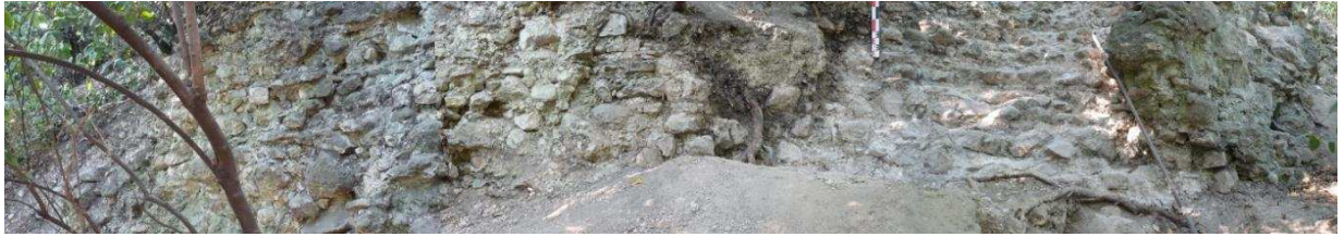
Figure 38 : Vue « panoramique » de la cortine à l'est de la tour Saint-Charles (Cl. E. Guilloteau/SAVN).
