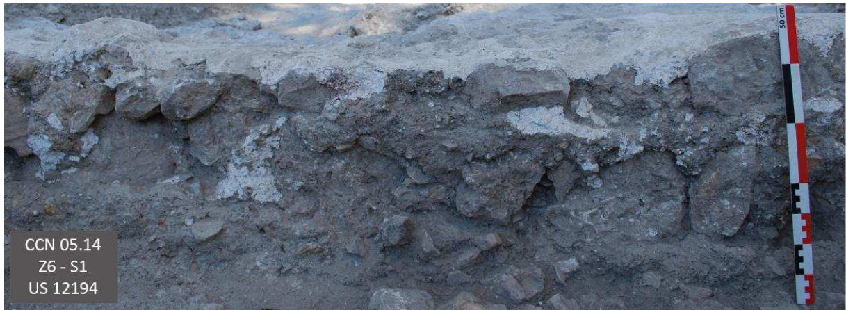
Figure 312 : Vue en coupe de la fondation de SB 12094 à partir du sud (cl. E. Guilloteau/SAVN).
