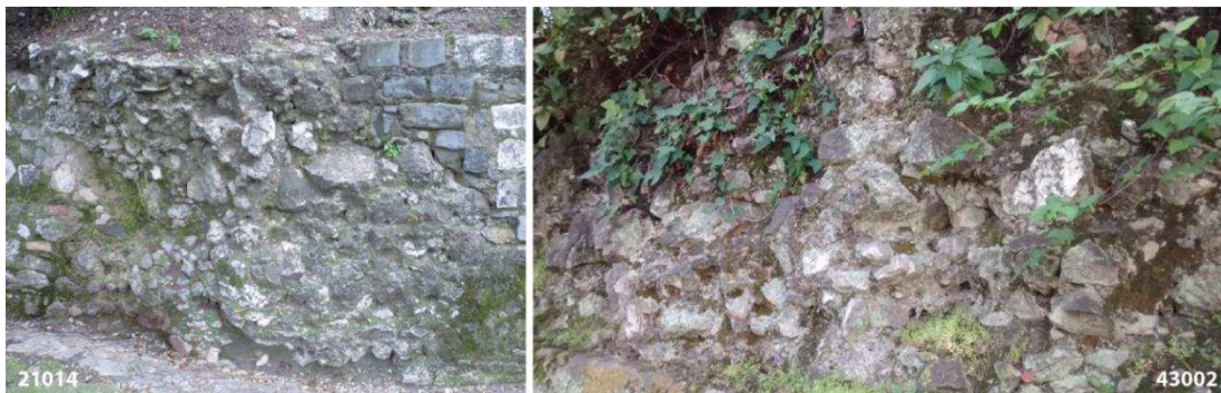
Figure 282 : Vestiges du blocage des faces des deux grands bastions (23, 28) (cl. E. Guilloteau).
