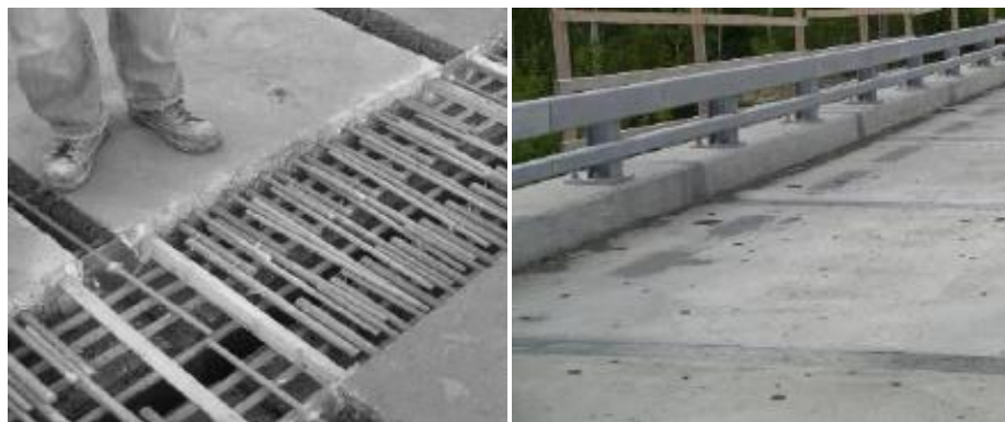
пр. 1 сн. 33: Запълване на фуги на мостови конструкции: Overhead Bridge (2006), Канада [Young, 2012]
