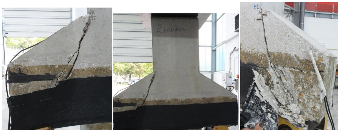
Figure 3-68 : Rupture de la console renforcée par plaques de deux côtés, 2 couches unidirectionnelles - CP2u
