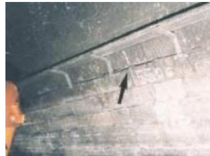
Figure 1-27: basculement d'une tête, tassement de fondation, glissement du versant.
