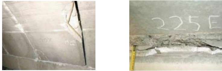
Figure 1-28: Epaufrure affectant la continuité du matériau
