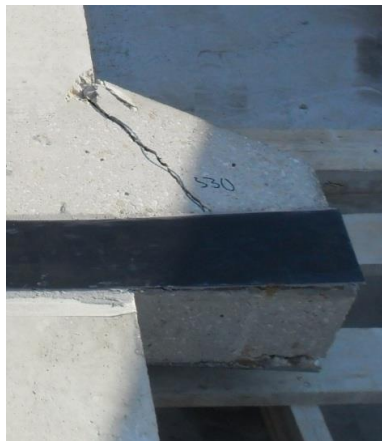
Figure 3-84: Rupture par compression + fendage + décollement de l'extrémité de la plaque
