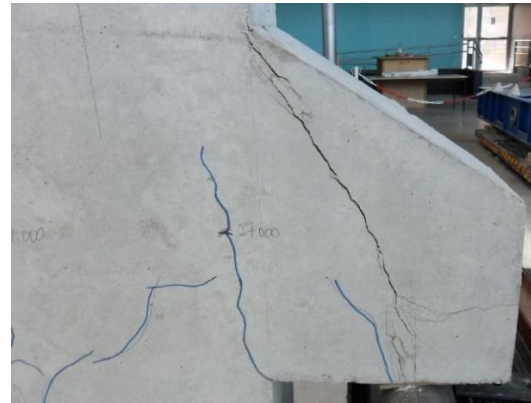
Figure 5-11: Vue de près de la fissure diagonale après 1 million de cycles
