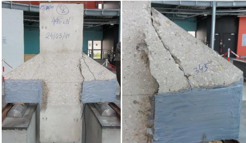
Figure 3-73 : Rupture de la console renforcée par plaque en forme U, 3 couches unidirectionnelles – CU3u
