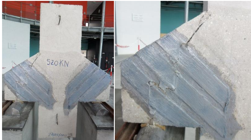
Figure 3-74 : Rupture de la console renforcée par bandes inclinées de deux faces (CI2b)
