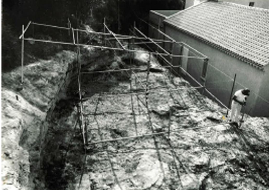
Figure 3 Vue de l'hypogée du Capitaine et du châssis tubulaire installé lors de la fouille. On peut remarquer la proximité de la villa avec le site ayant entraînée la fouille et la paroi nord de l'hypogée à droite du cliché (cliché G. Sauzade, 1976)
